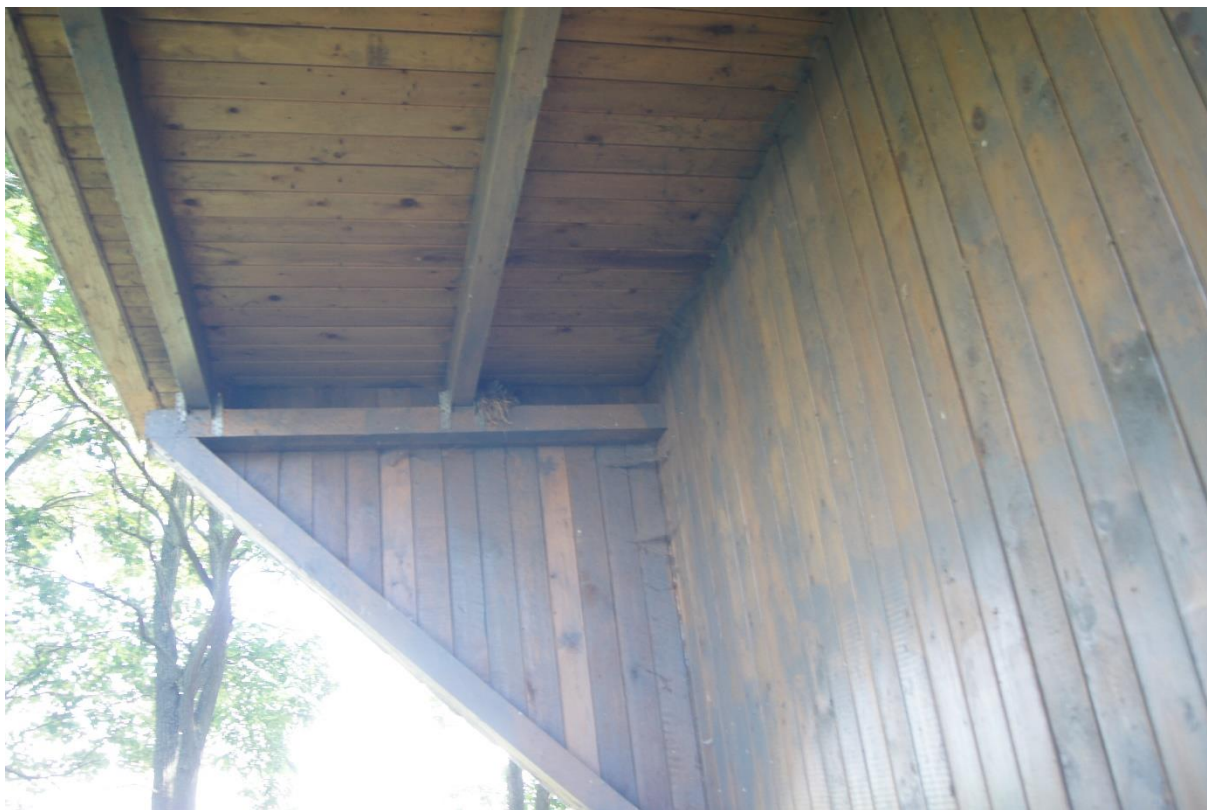
Bild 26 Gebäude 06 Schuppen Nordwestseite - Hausrotschwanznest
