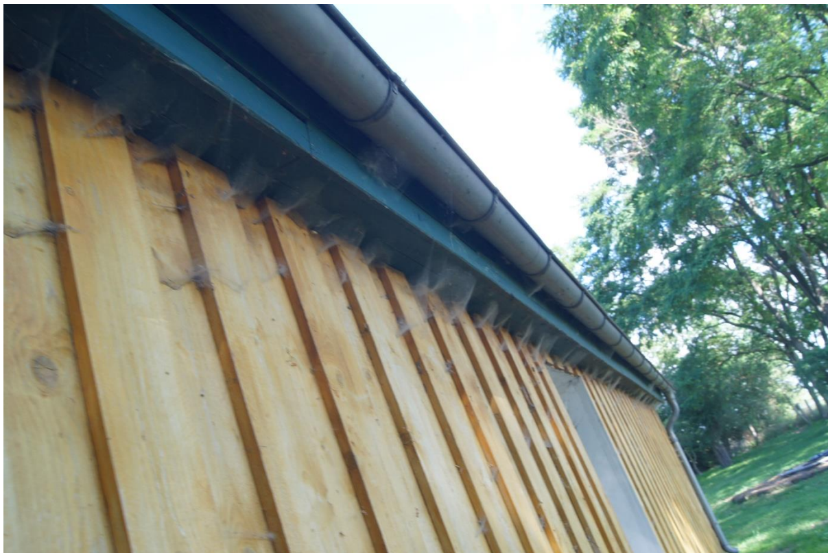
Bild 23 Gebäude Bild 01 Ostseite fest gefügte Bauteile- Spinnweben
