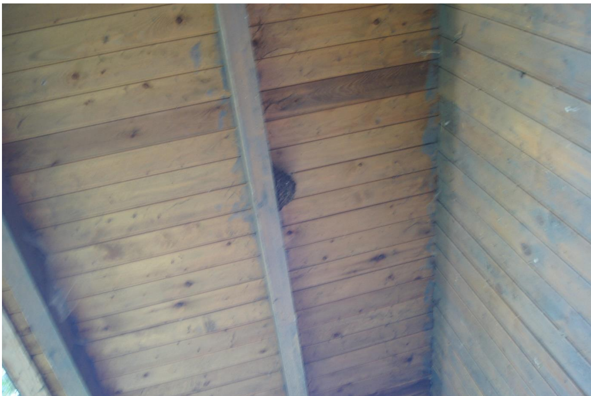
Bild 28 Gebäude 06 Schuppen Nordwestseite - Rauchschwalbennest
