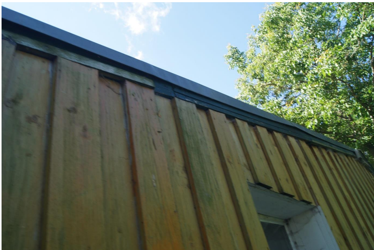
Bild 24 Gebäude Bild 01 Nordgiebel- Verblechungen potenzielle Spaltenquartiere
