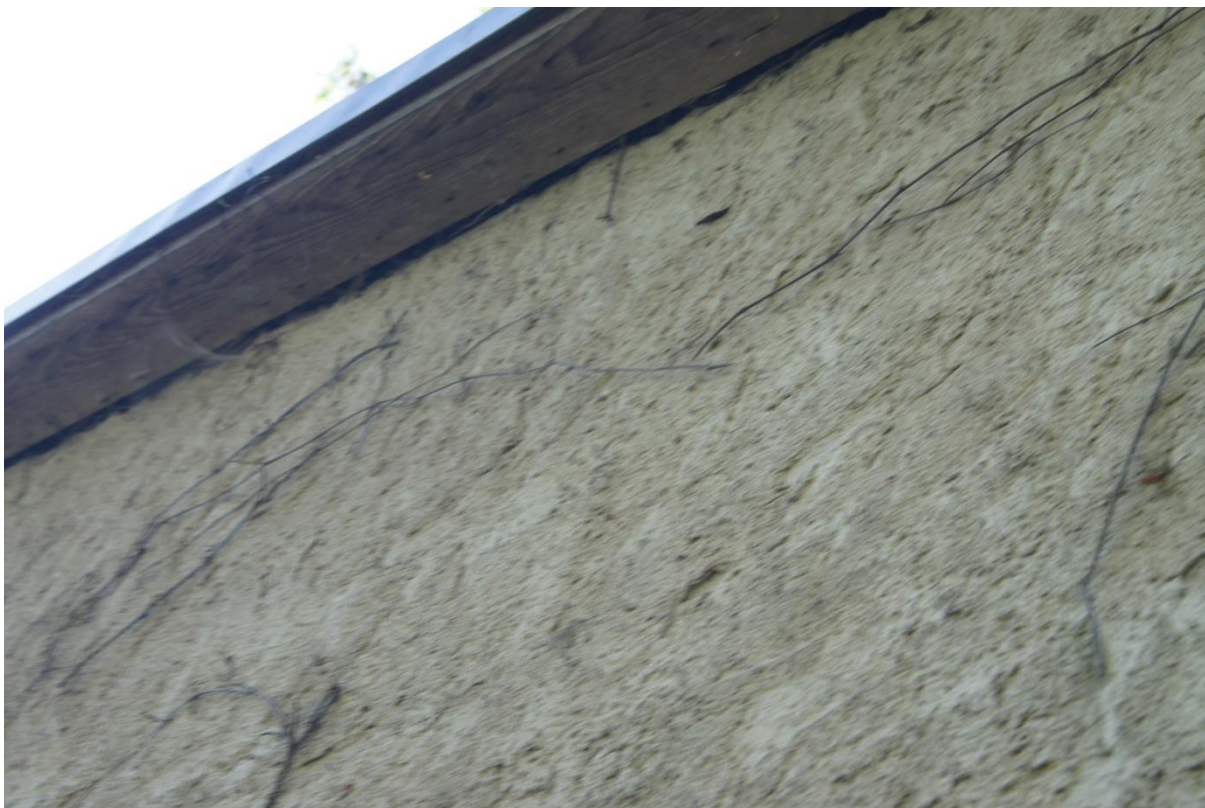
Bild 16 Gebäude Bild 02 Nordgiebel- Spalten mit Spinnweben
